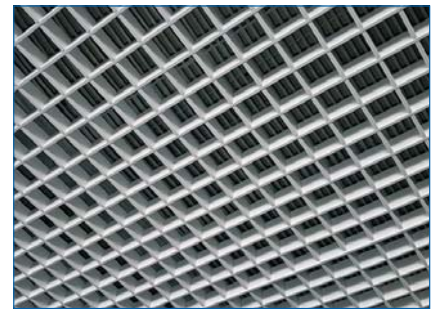
Nahezu unsichtbar: naturfarbene Kapillarrohrmatten verbinden sich zu einer Einheit mit der offenen Decke
